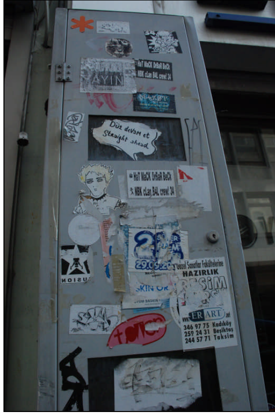
Şekil 96. Etiketlere örnekler elektrik kutusu (Gizem Erdoğan'ın arşivinden, Haziran, 2009)
